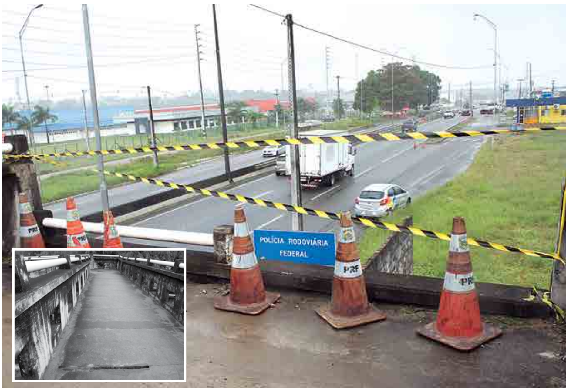
Além das falhas no piso e da falta de iluminação, uma balastrada de contenção da passarela da BR-230, em Bayeux, desabou, trazendo mais insegurança a quem precisa fazer a travessia
